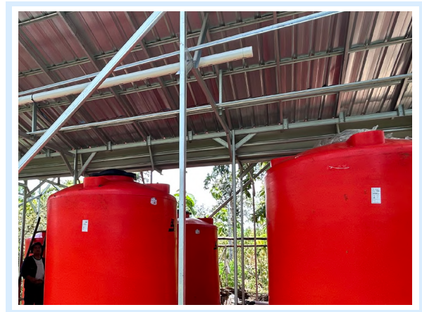
Penampungan Air Hujan untuk Irigasi Kabut Cerdas di Dusun Temon, Kalurahan Giripurwo, Purwosari, Gunungkidul. Foto: Nanda/YEU
